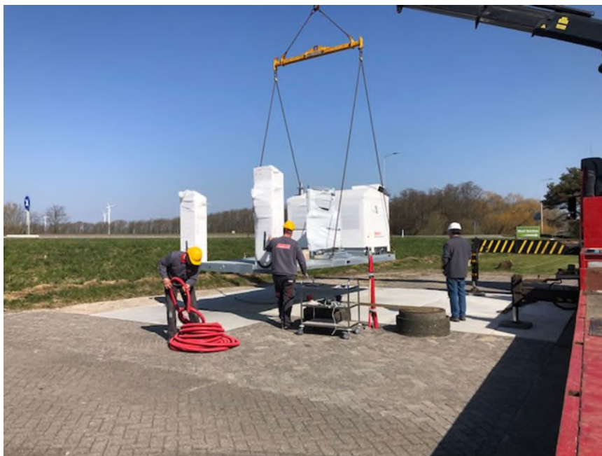
Fotovoorbeld van eerder gerealiseerde installatie
