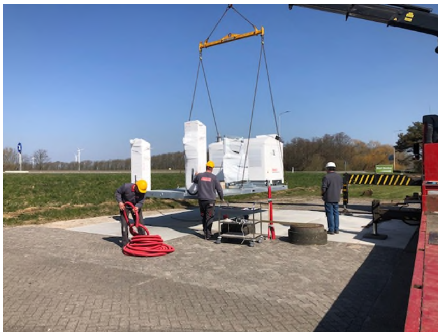
Fotovoorbeld van eerder gerealiseerde installatie
