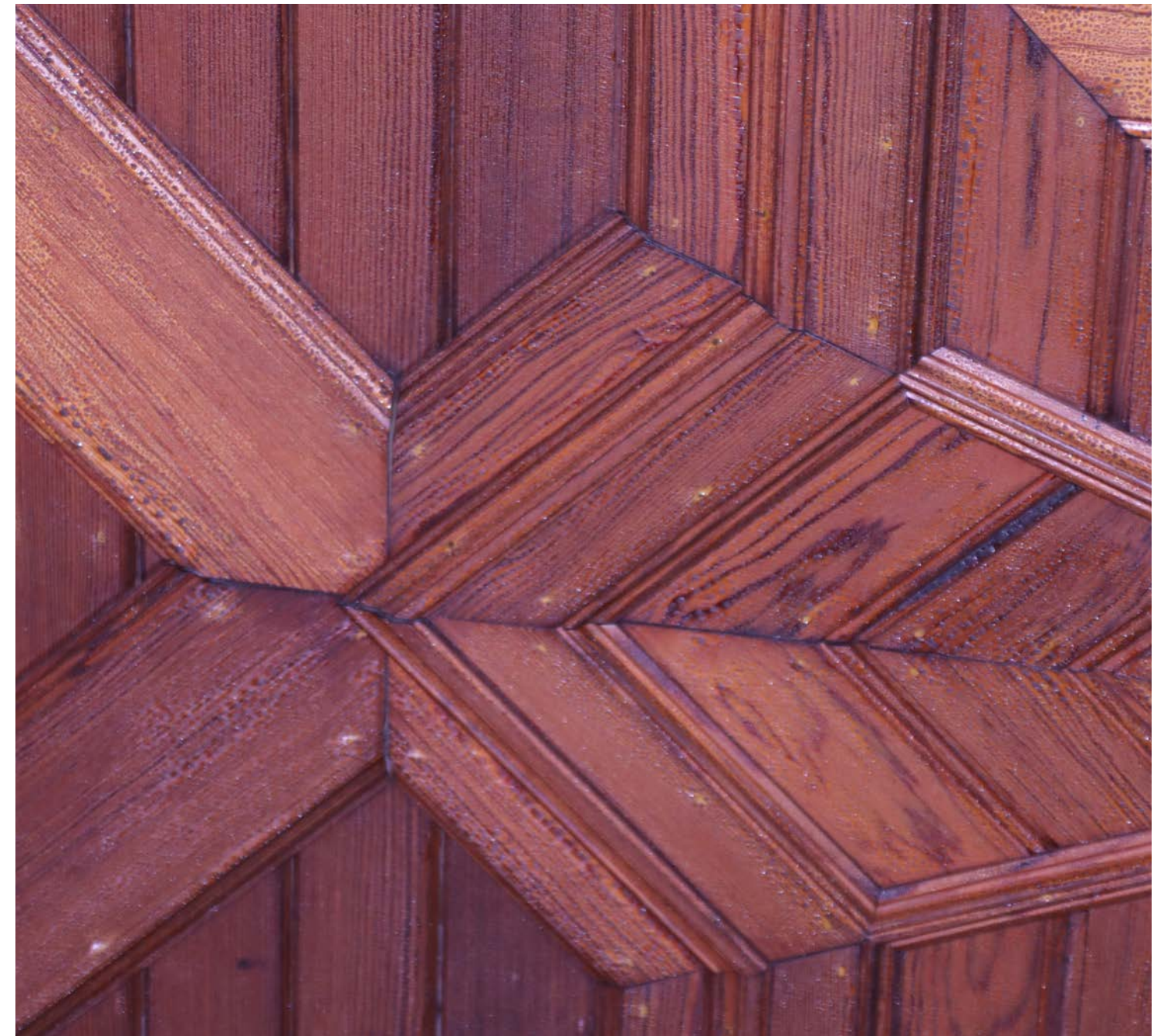
Aantasting plafond door vernis lagen, sigaretten rook en mogelijk andere behandelingen
