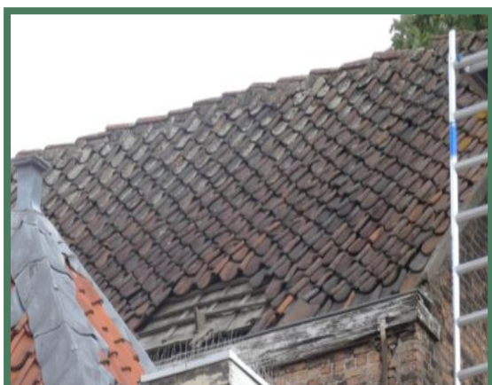
Foto 1: Dak met scheefliggende en ontbrekende dakpannen.
