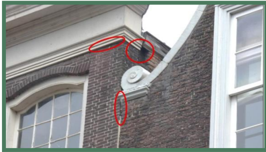
Foto 3: Oppervlakkige kieren en diepere gaten in de voorgevel.
