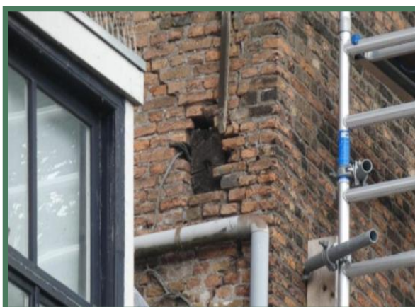
Foto 2: gaten in de westgevel.
