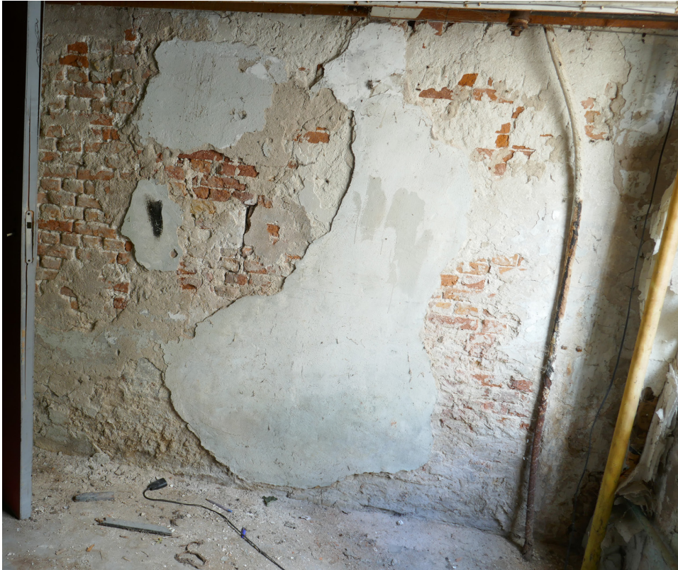
Afb. 4.18 Tegen de westwand van 0.01 ontbraken (met name tegen de voorgevel) grote delen van het pleisterwerk, waardoor het achterliggende metselwerk zichtbaar werd. Mogelijk betrof het hier nog een oude, woning-scheidende tussemuur.
