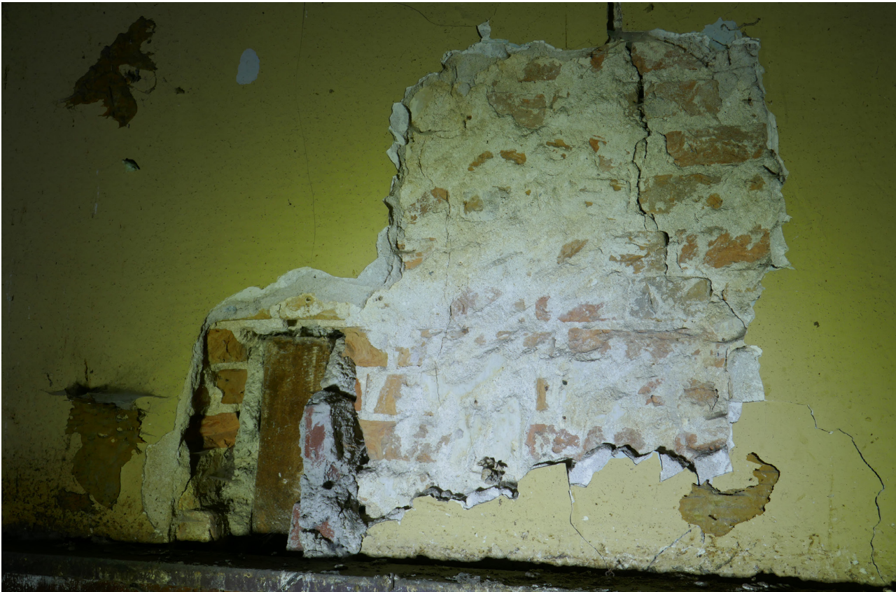
Afb. 4.89 Tegen de oostwand van 2.01 waren via enkele beschadigingen in het pleisterwerk, stukken van het achterliggende muurwerk zichtbaar. Deze waren iets te klein om het muurwerk echt te duiden.
