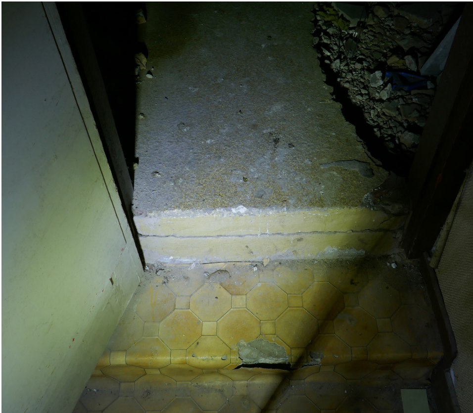
Afb. 4.36 De vloer van 0.04c lag bijna 40 cm lager dan die van 0.05, hetgeen met een trapje werd overbrugd. Op de trede is goed te zien dat de vloerafwerking van 0.04c geen echte tegels betrof, doch een vloerzeil.
