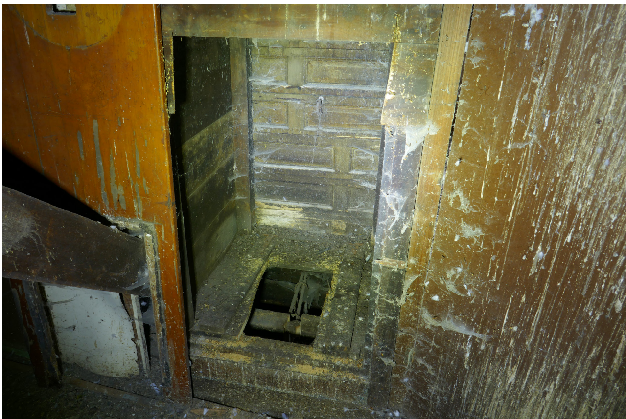
Afb. 4.96 Foto van de tweede ventilatiekoker (zie 4.94), die nog overeind stond. Onderaan keek men direct ruimte 2.01 in. De wanden waren deels van hergebruikte raamluiken gemaakt.
