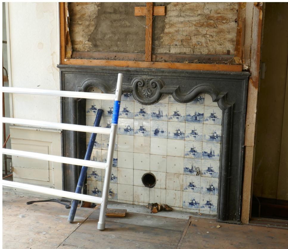
Afb. 4.70 Foto van de schouw tegen de westwand van 1.03. De natuurstenen schouw stamt mogelijk nog uit de 18e eeuw; de tegelvulling is echter vroeg 20e eeuws. Daarboven is het rookkanaal te zien waarop een frame met enkele behanglagen werd aangetroffen (zie ook 4.72).
