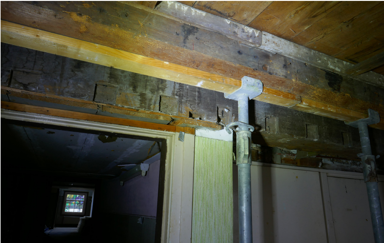
Afb. 4.29 In het plafond van 0.03 was tegen de grens met ruimtes 0.04a, b en c een moerbalk aangebracht. Deze was duidelijk hergebruikt (omgedraaid) en zijn oorspronkelijke locatie is onbekend.
