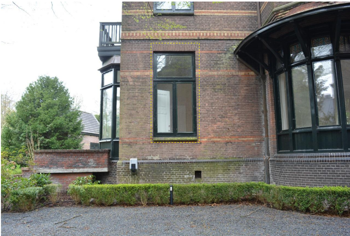
foto 13. Onderzijde achterste travée linker zijgevel met later geplaatst (ergo: niet origineel) raamkozijn, april 2022
