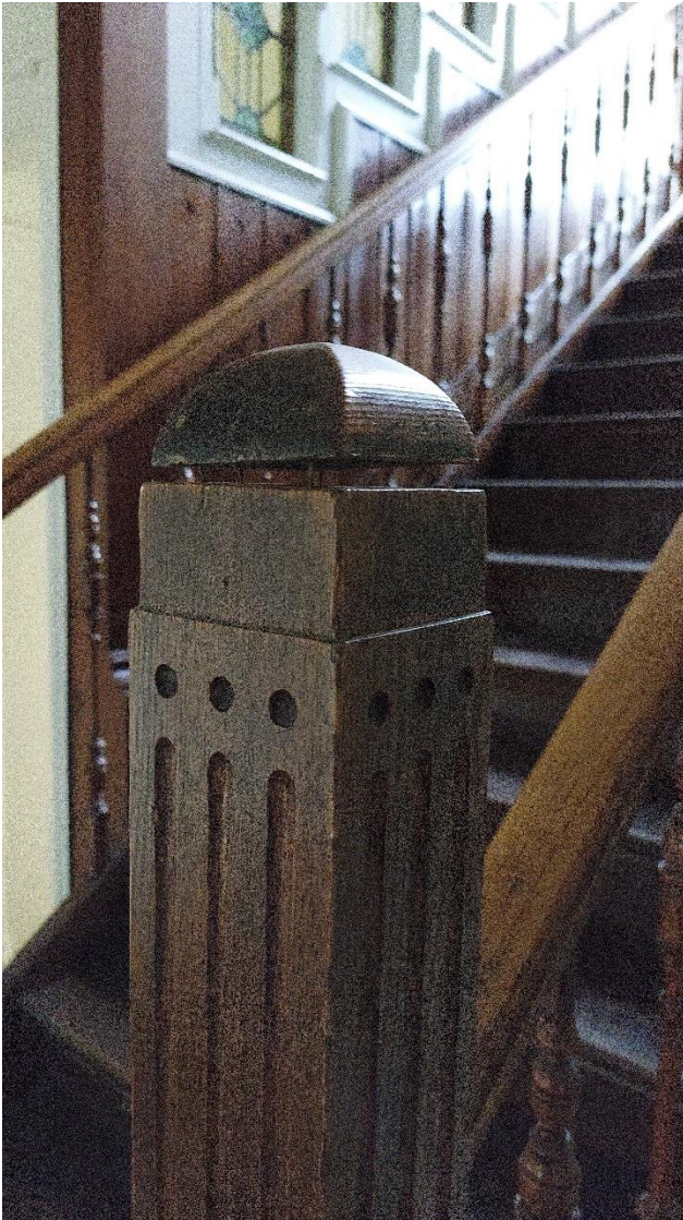
foto 29. Detail trapbaluster met afkomend dekplaatje, onder het dekplaatje was een buis voor elektradoorvoer zichtbaar, ruimte 0.1, april 2022
