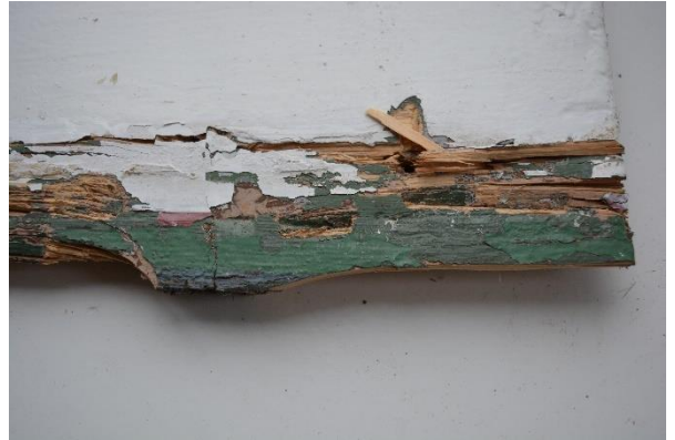
foto 52. Verfresten op stuk houten lambrisering (in atelierruimte 2.1), april 2022
