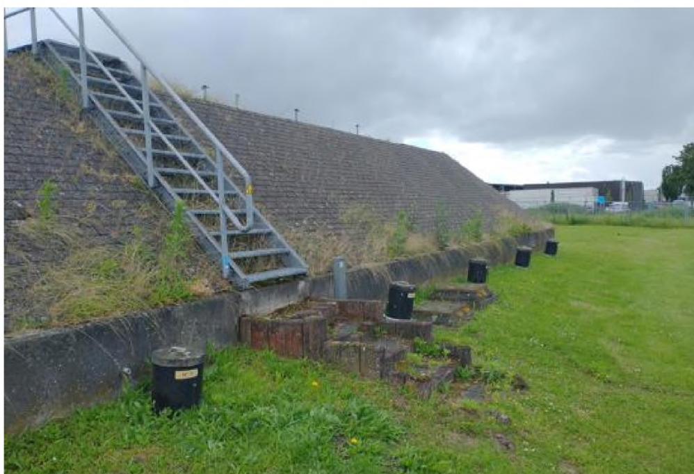
Figuur 5.4 Drainageputten aan de westkant van de tankenterp
