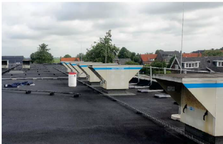
Figuur 4.1.1 Afbeelding van de afzuiging van de luchtbehandelingskast
