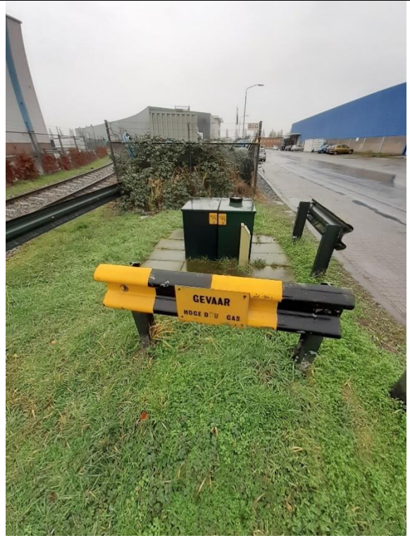
C.4. Electriciteitskast Stedin op deellocatie C.
