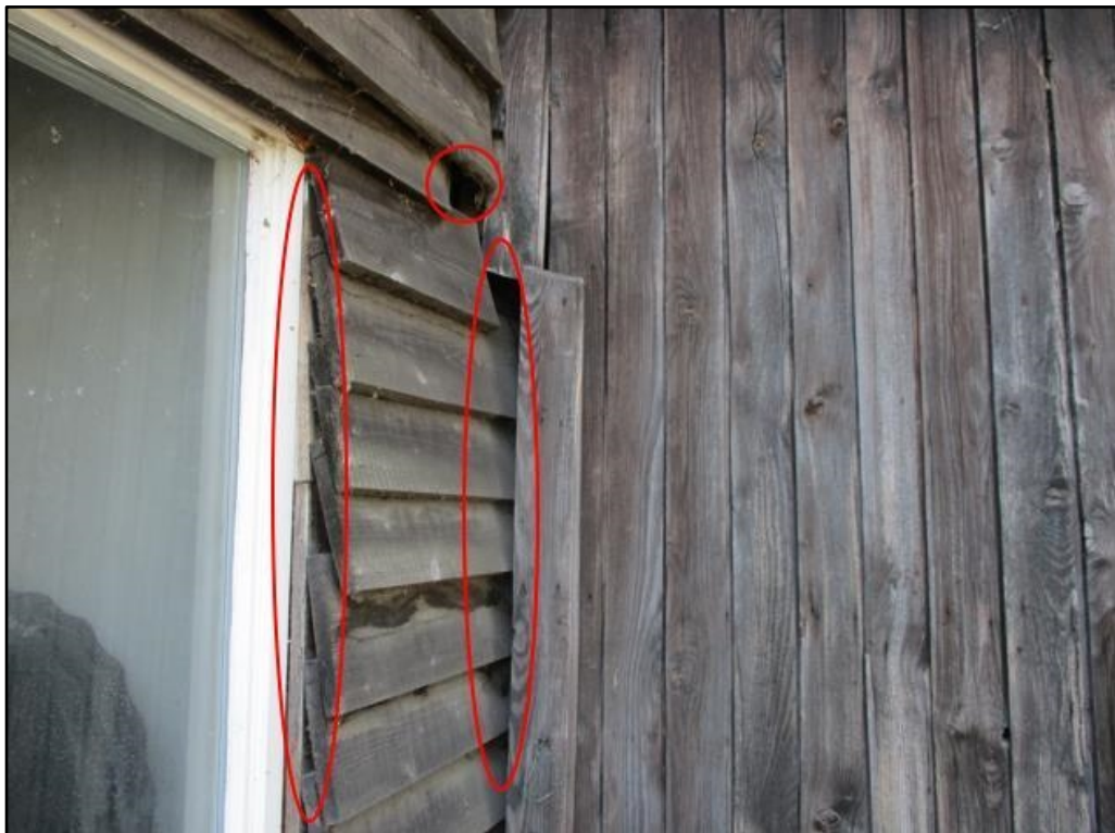
Figuur 5 Kieren achter de potdeksels welke echter niet geschikt zijn bevonden als potentiële verblijfplaatsen.
