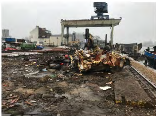
Foto 9: Schroot, afval en overig materiaal op locatie
