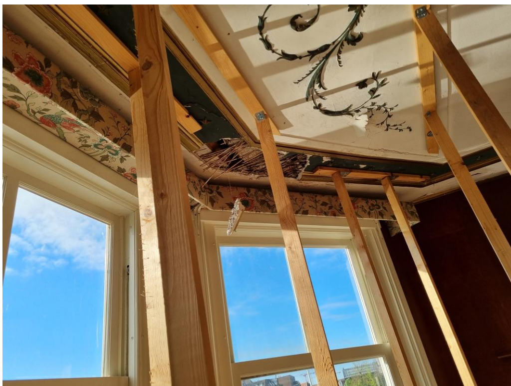
Schade door lekkages. Gordijnkoven verwijderen, plafond herstellen.
