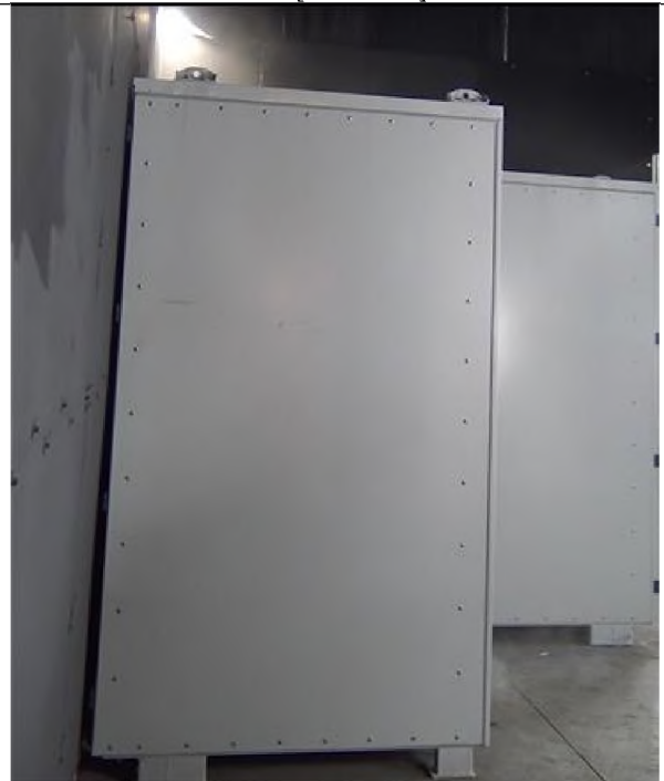
(d) Cell 19 thermal runaway [00:43:12]
