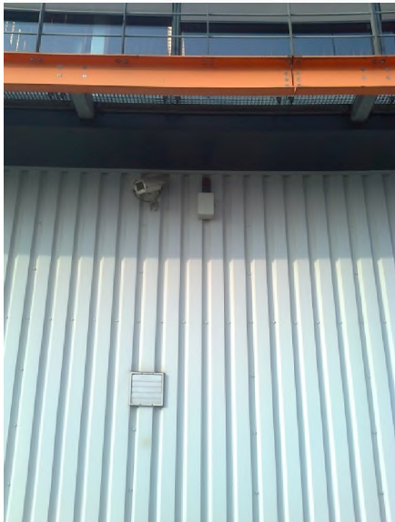
Rood + groene waarschuwingslamp achterzijde gebouw 2 --> windsnelheid alarm voor torenkraan
