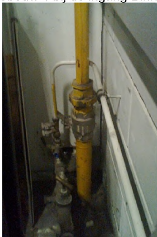
Gasafsluiter ingang Binnendienst (rechts naast spuitcabine)
