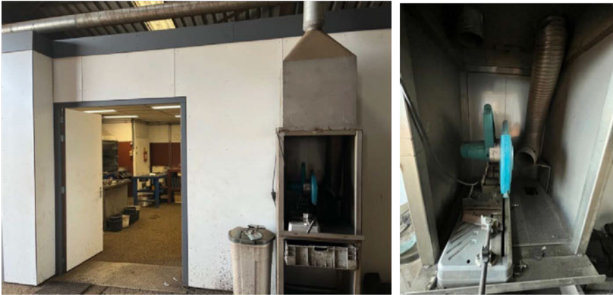
Figuur 8: afzuig- en filter-units.
