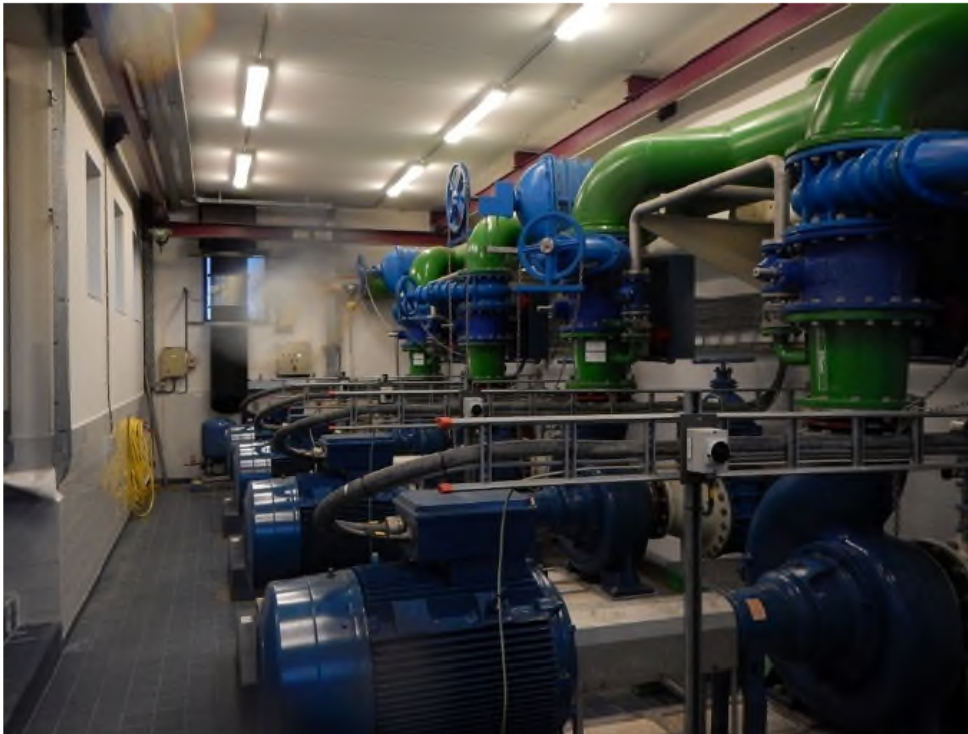
Figuur 4.1: Effluentpompen in pompegebouw. Bron: Fotoreportage (bijlage B) ABV Haukes bodembescherming d.d. 29 januari 2018
