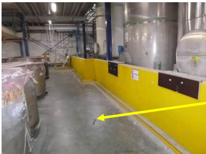
Fotonr.: 1 Gebrek: Boorgaten in betonvloer nabij bindmiddelen tanks.
