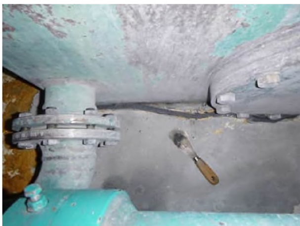
Fotonummer: 3 Omschrijving: Plaatselijk onthechte voegvulling bij aansluiting betonvloer/tank achter wasser.
