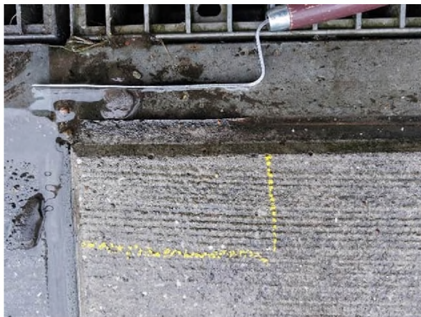
Fotonummer: 3 Omschrijving: Onthechting van de voegvullingsmassa.
