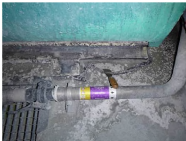
Fotonummer: 4 Omschrijving: Onthechte voegvullingsmassa bij aansluiting betonvloer/wasser.
