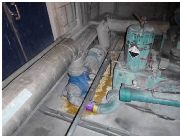
Fotonummer: 6 Omschrijving: Door product is de voorziening voor een deel achter de wasser niet inspecteerbaar.
