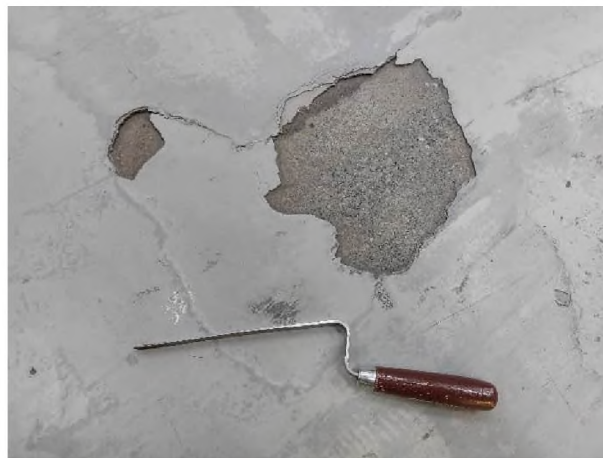
Fotonummer: 2 Omschrijving: Onthechting/ mechanische schade van de coating.
