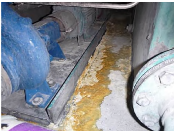
Fotonummer: 5 Omschrijving: Door product is de voorziening voor een deel achter de wasser niet inspecteerbaar.
