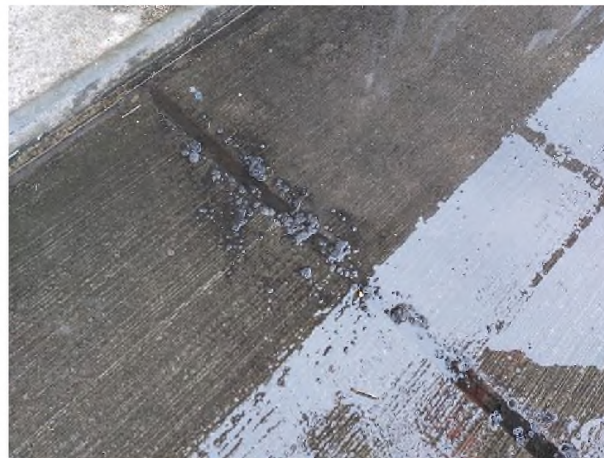
Fotonummer: 4 Omschrijving: Door vuil op de voegen is de voorziening niet goed inspecteerbaar. Het is dus mogelijk dat er meer onthechtingen in de voegvullingsmassa zitten dan de vastgestelde 3,5 meter.
