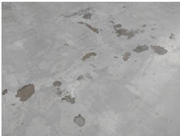
Fotonummer: 3 Omschrijving: Onthechting/ mechanische schade van de coating.
