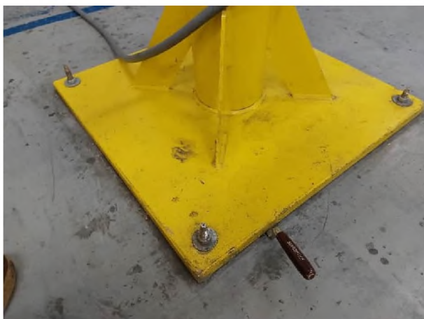
Fotonummer: 5 Omschrijving: Bevestigingspunten zijn niet vloestofdicht afgewerkt zoals bij de vatenbalancer.
