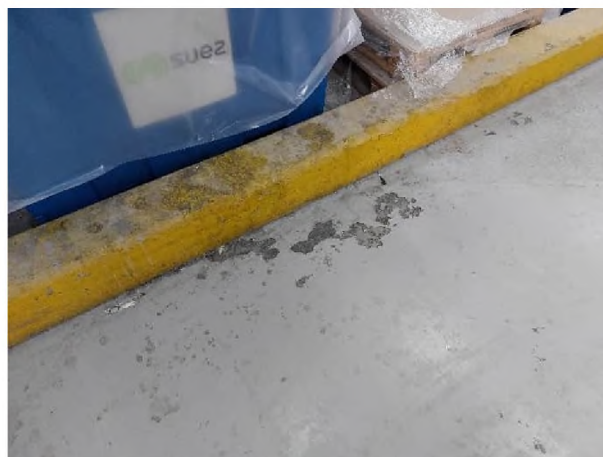
Fotonummer: 6 Omschrijving: Onthechting/ mechanische schade van de coating.
