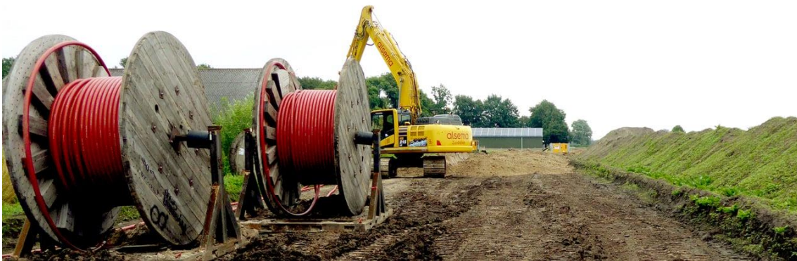
Figuur 4.3 Grote kabelhaspels voor netaansluiting
